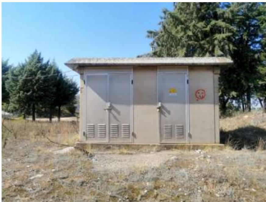
Слика 1.4/1 Трансформаторска станица
