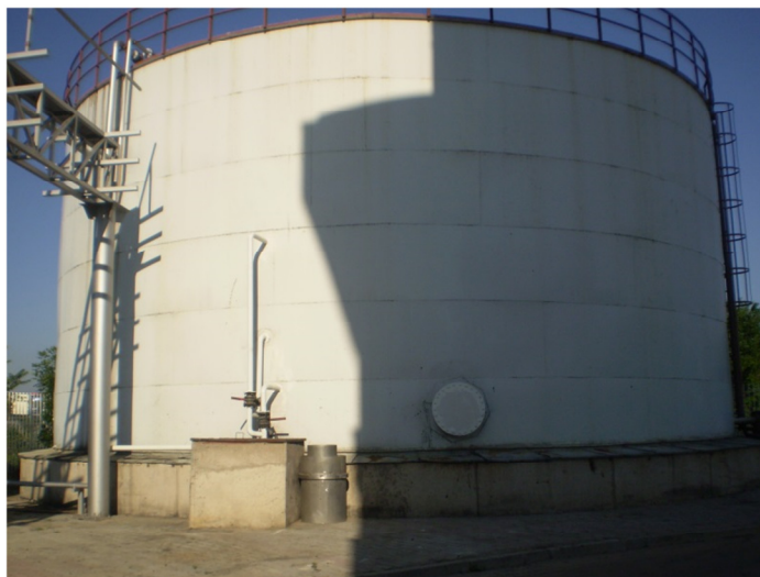
Слика бр. 3. Надземни резервоари за складирање суровина
