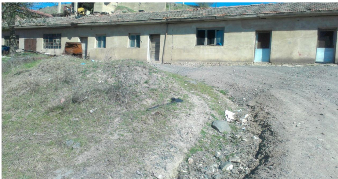
Слика. 4. Повекенаменски објект (канцеларија на раководителот , трпезарија , браваркса работилница , соба за резервни делови , гардероба , помошна просторија)
